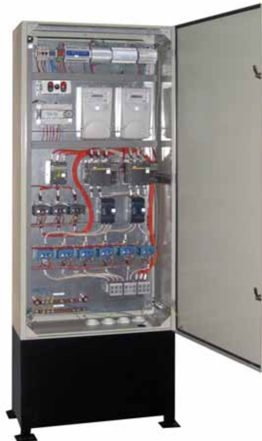
Рисунок 4 – Шкаф управления ПВ
